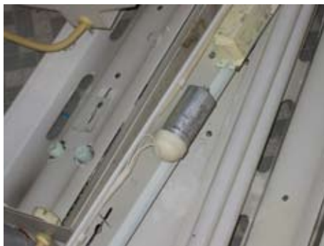
Kondensatorn sitter ofta väl skyddad. Låt den därför sitta kvar i elavfallet!
