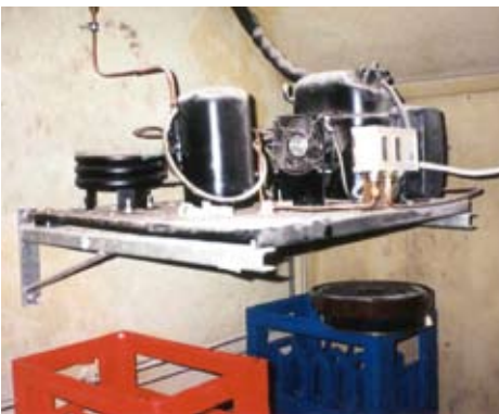
Platsbyggd kylanläggning för mindre kylrum.
