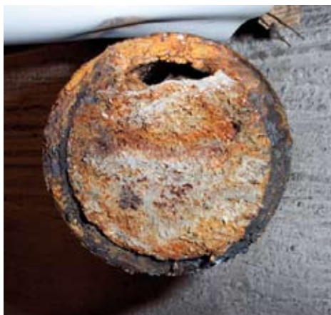
Avloppsrör i genomskärning, fyllt med amalgam. Från nedlagd tandläkarmottagning.
