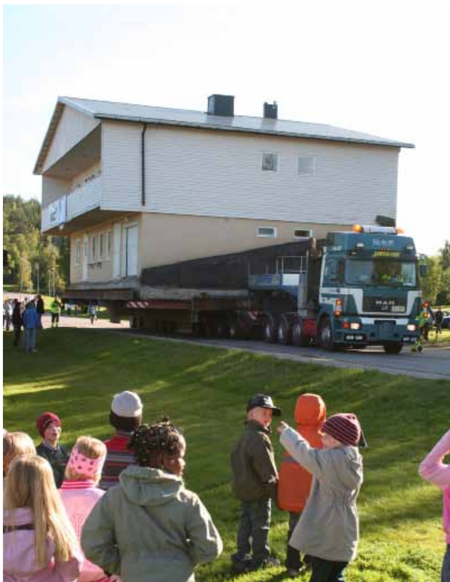
Medan flerbostadshuset måste rivas och ersättas kan många av villorna flyttas. Här är en av dem på väg mot sin nya tomt. FOTO: LKAB
