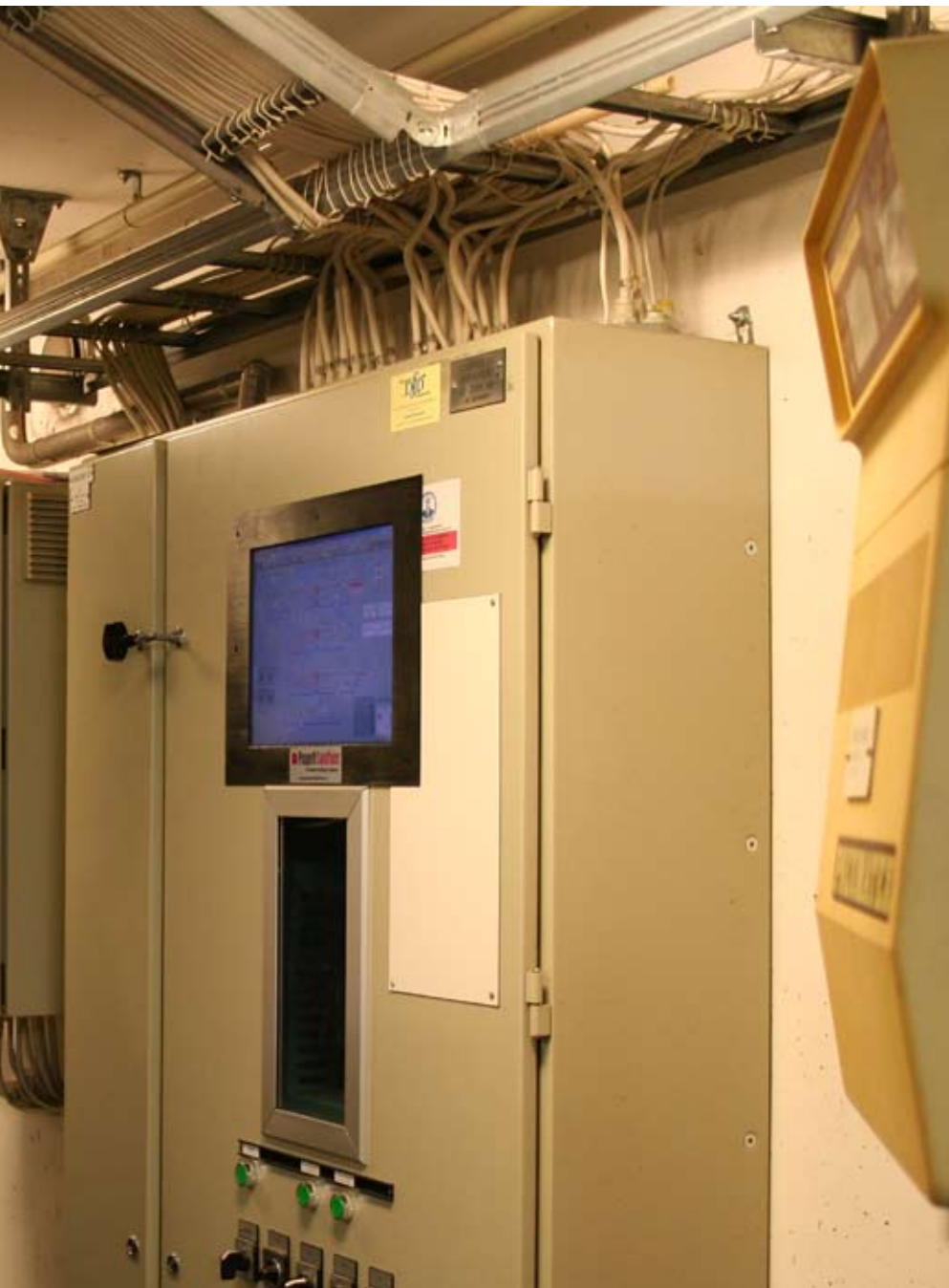
Ulf Andersén, tekniskansvarig i Brf Hantverkaren 25, tittar till föreningens anläggning, som bygger på driftsövervakning.
