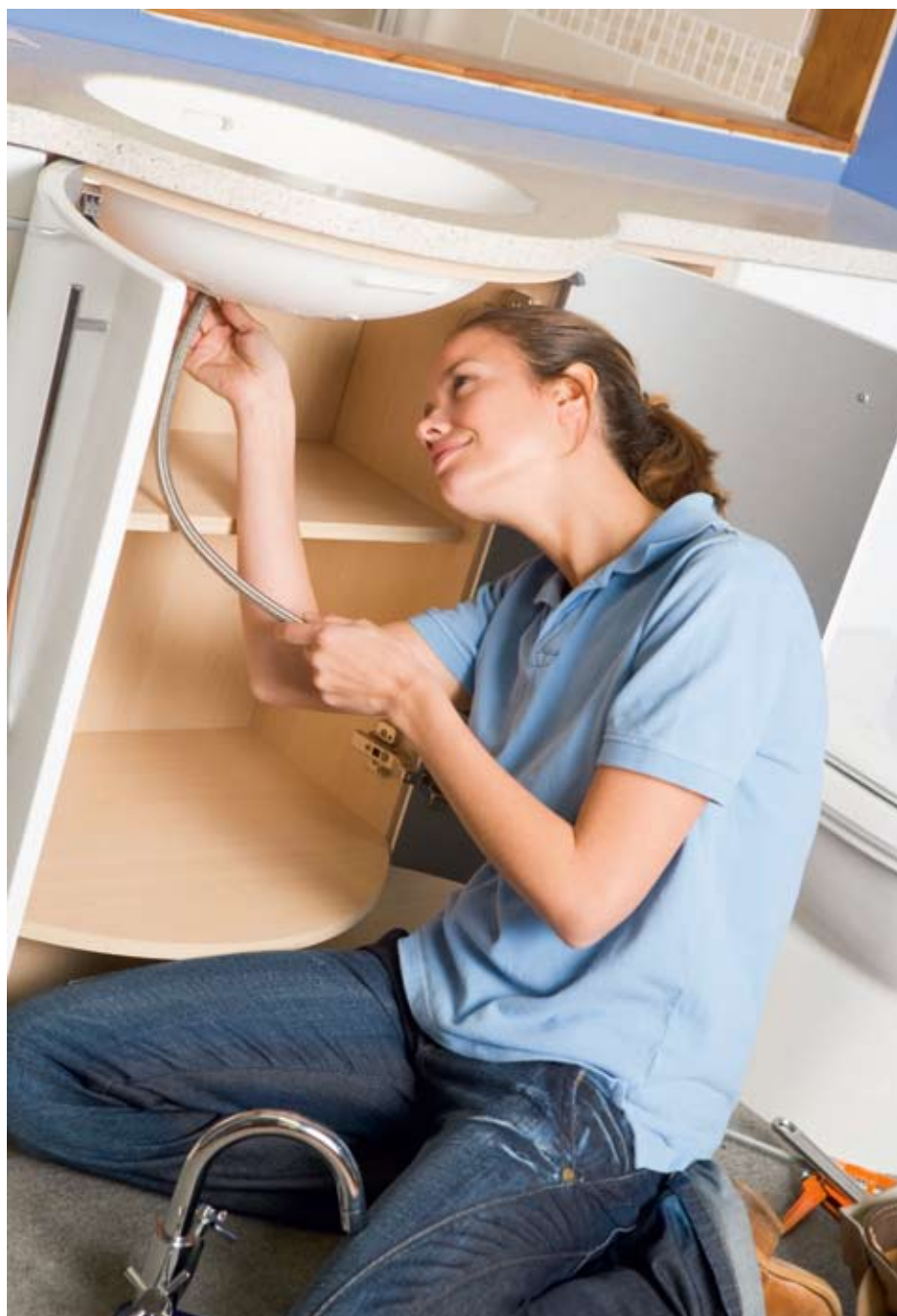
Bara auktoriserade företag får skriva intyg om att installationen är utförd enligt reglerna i Säker Vatteninstallation .
