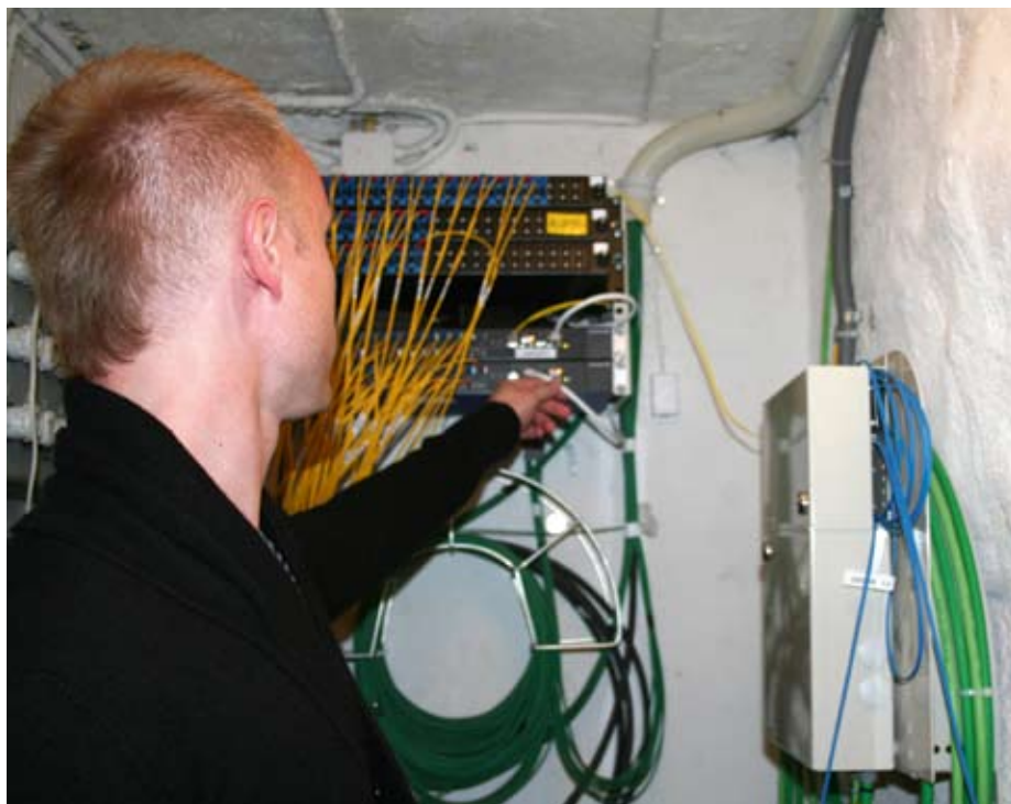
Viktigt att hitta ett utrymme för utrustningen innan man börjar installationen.
