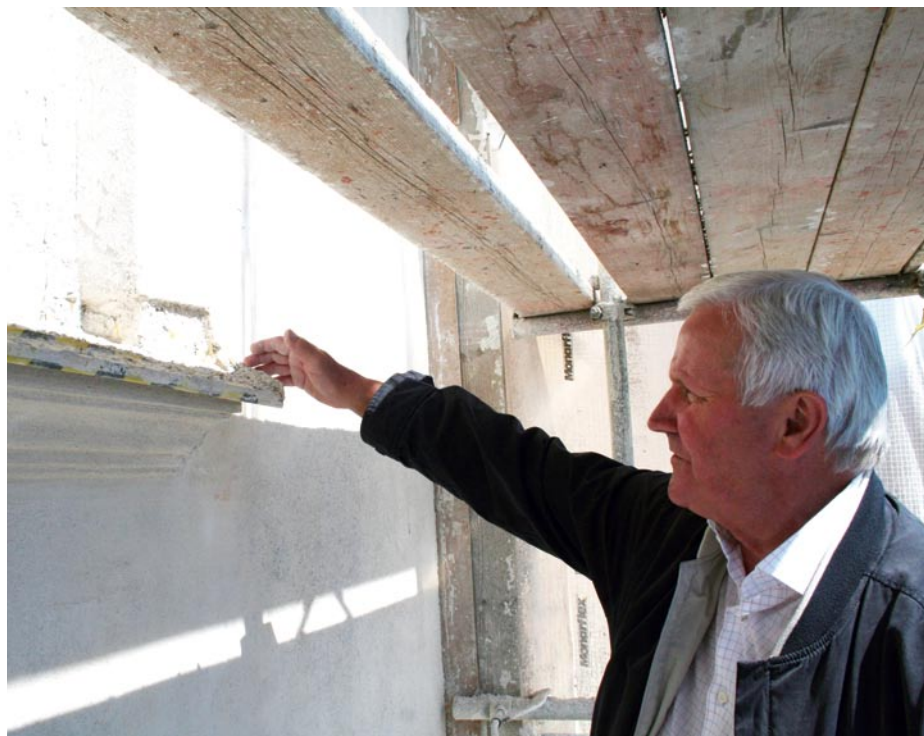
Leon Eriksson vet var fasadens känsliga punkter finns – och att det kan bli en riktigt dyr affär om fasadunderhållet blir eftersatt.
