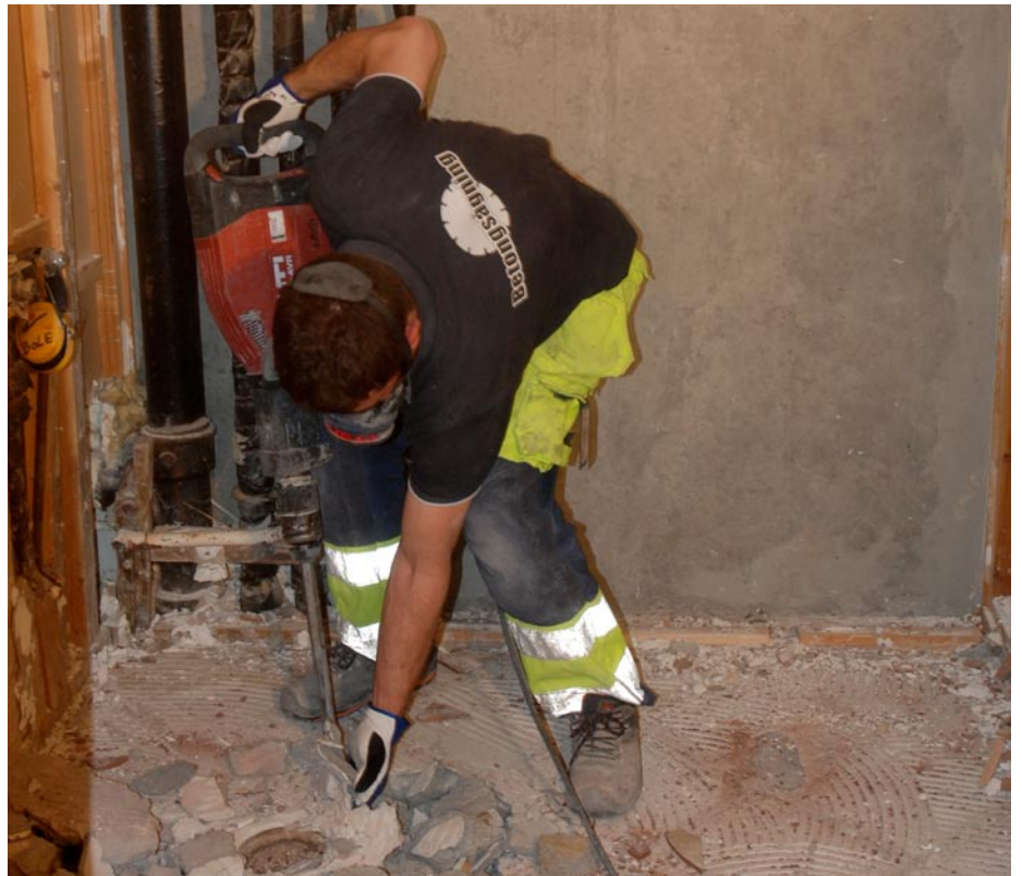
Bosko Savic river betonggolvet i ett av badrummen.
