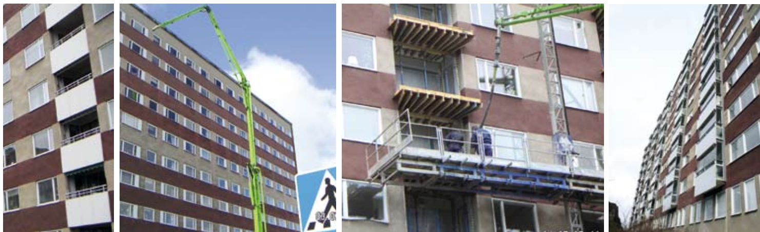
Balkongerna som de såg ut innan. Bygget gick smidigt trots svårigheten att komma fram med maskiner, betongen pumpades över hustaket. De utgjutna och inglasade balkongerna sticker ut 60 centimeter från fasaden.
